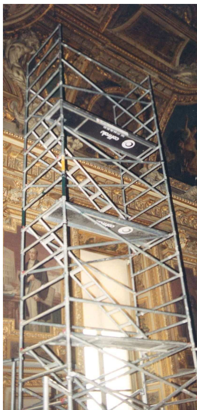
Le décret 65.48 exige un plancher tous les 3 mètres.
