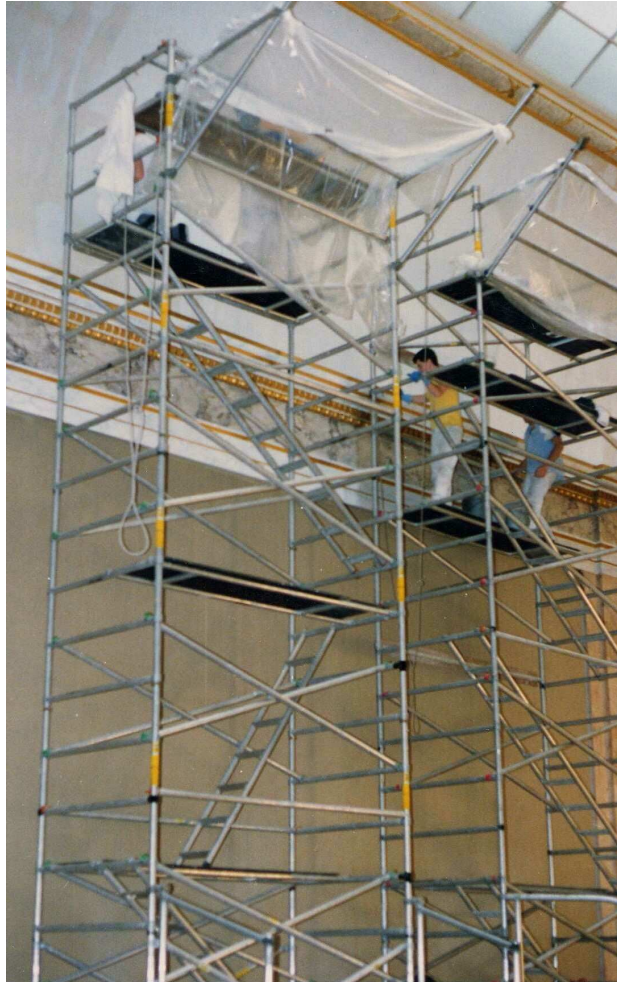
Le décret 65.48 exige un plancher tous les 3 mètres.
